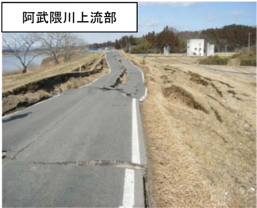
地震による堤防の被災状況
