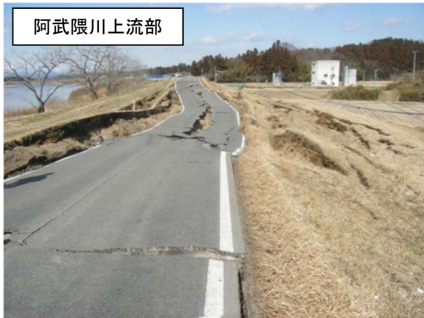
地震による堤防の被災状況
