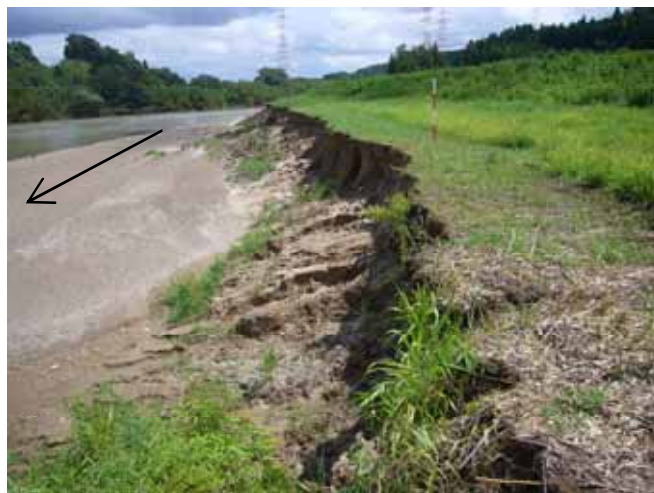
写真 2. 1. 1 川内川堤防被災状況
