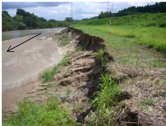
写真 2. 1. 1 川内川堤防被災状況
