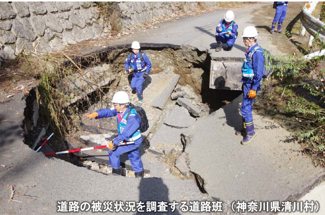
崩壊箇所の被災状況等を助言する砂防班(埼玉県飯能市)
