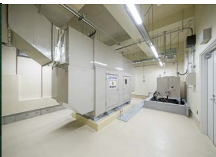
自家発電設備
