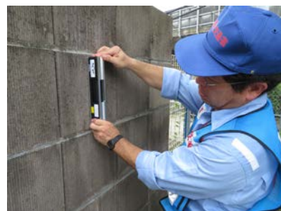
既設塀の傾きの確認
