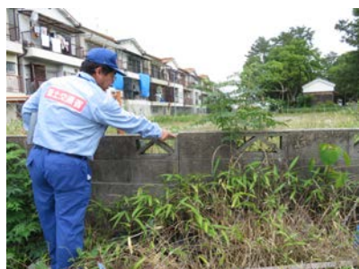
既設塀のずれの確認
