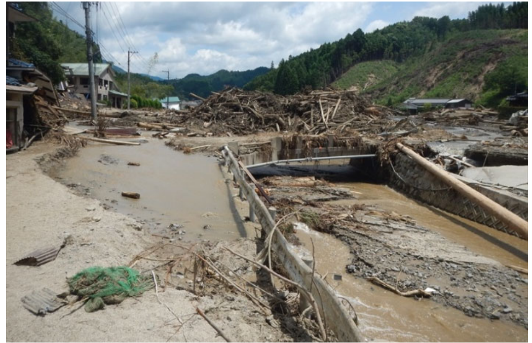
橋梁に倒木が詰まった状況
