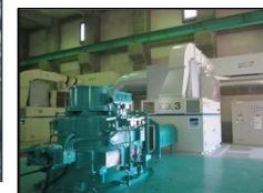
増強工事後のポンプ
