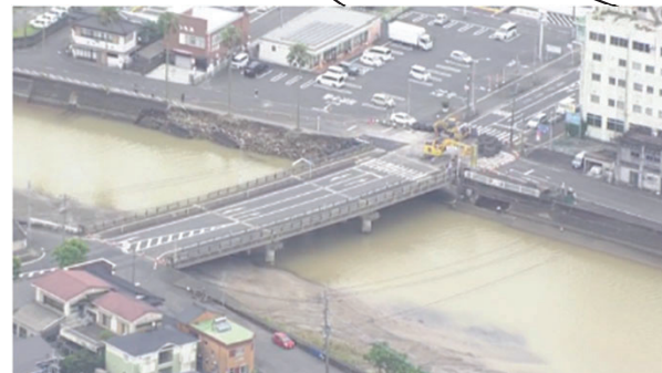
始良市加治木町 網掛川 護岸崩壊状況
