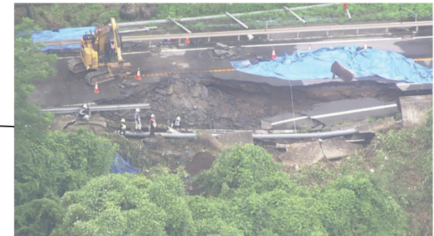
霧島市隼人町 国道10号 土砂崩れ
