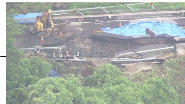
霧島市隼人町 国道10号 土砂崩れ
