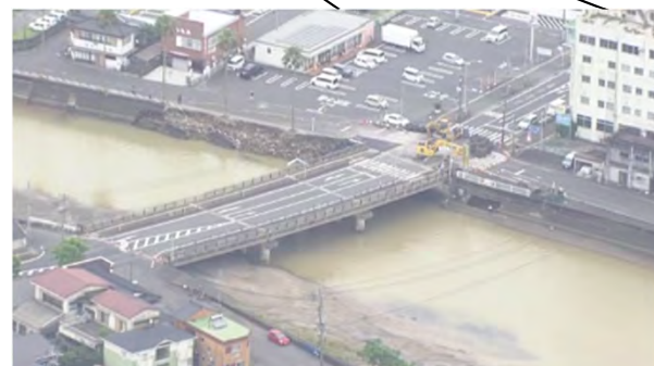
始良市加治木町 網掛川 護岸崩壊状況
