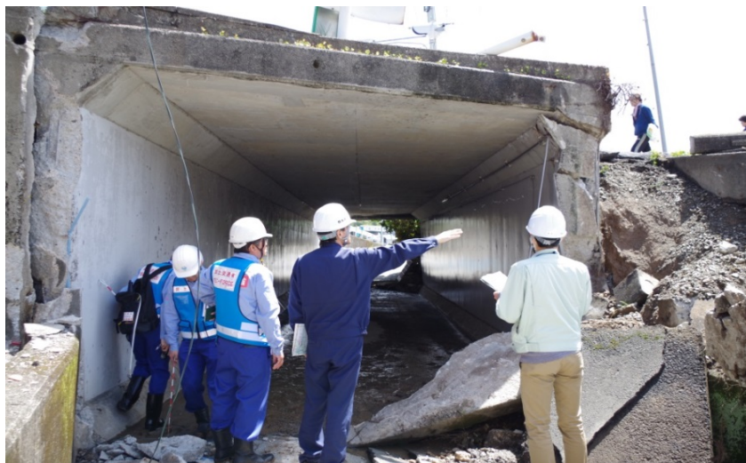
▲ 道路構造物の被災状況を調査（益城町）
