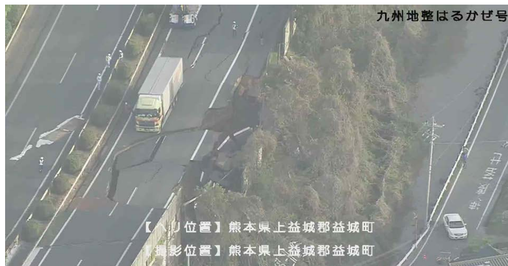
▲ 九州自動車道の陥没
