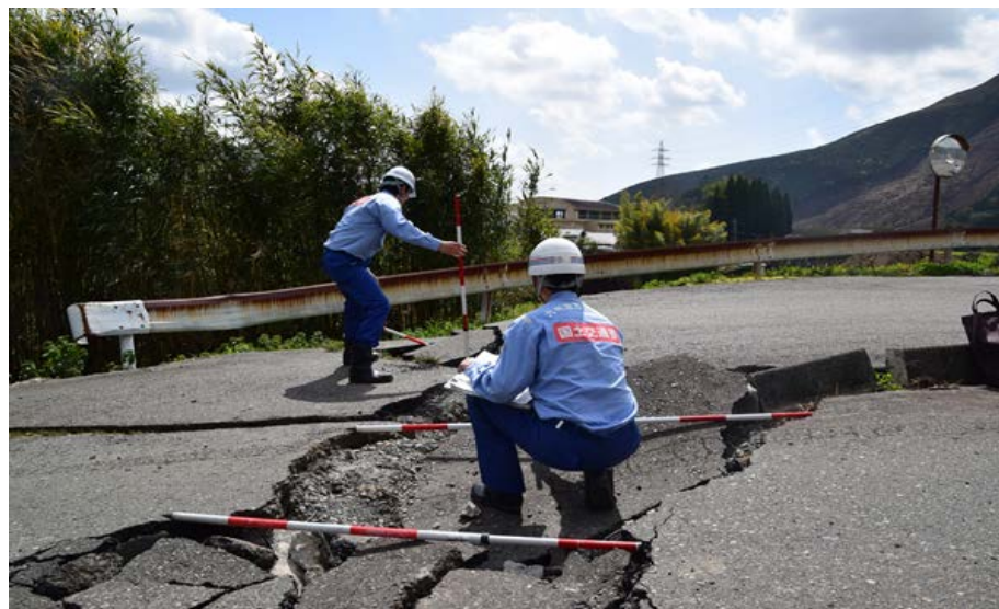
▲ 道路被災箇所を調査
