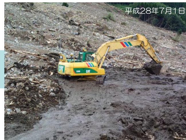
降雨によって重機足場が泥濘化し作業が難航
