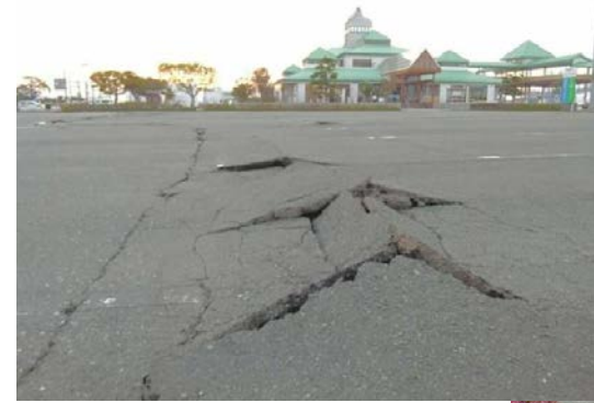
▲地震の影響でフェリーターミナル駐車場の舗装面が隆起やクラック等が発生し利用が出来なくなった。
