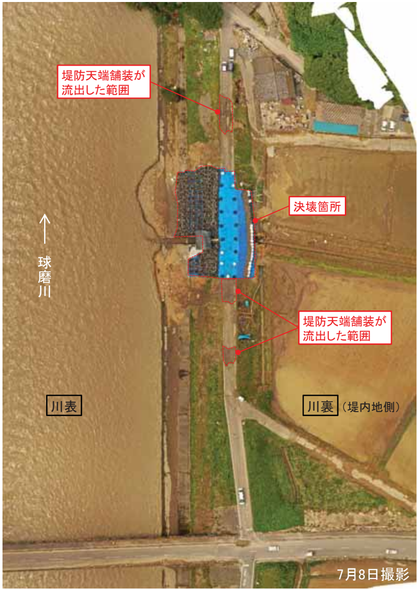
■決壊後の状況
