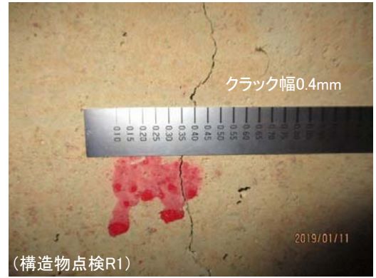
函渠内のクラック拡大写真
