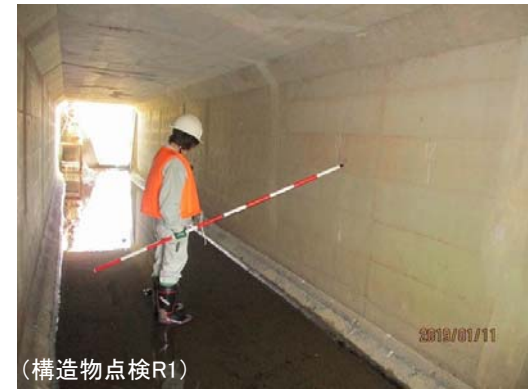
函渠内のクラック
