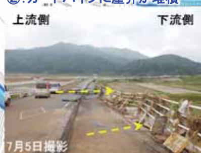
②：ガードパイプに塵芥が堆積
