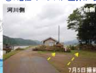
⑥：電柱・フェンスに塵芥が堆積
