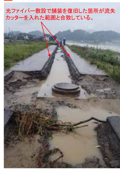
6 右岸58.6k付近 被災後
