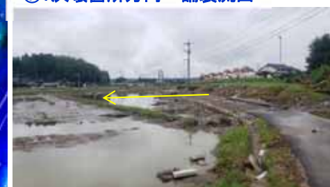
⑦: 決壊箇所方向へ舗装流出
