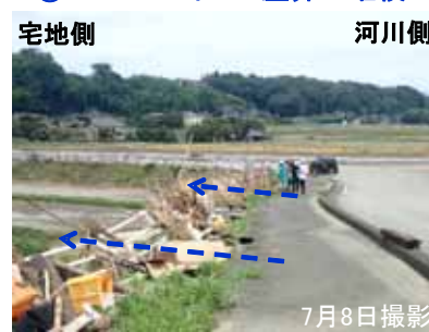
④: ガードパイプに塵芥が堆積
