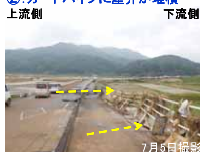
②: ガードパイプに塵芥が堆積
