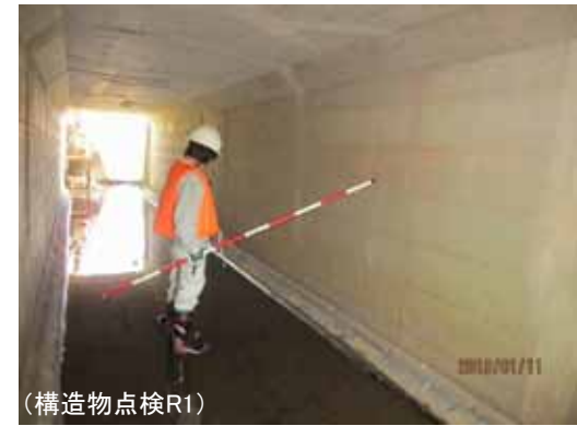
函渠内のクラック
