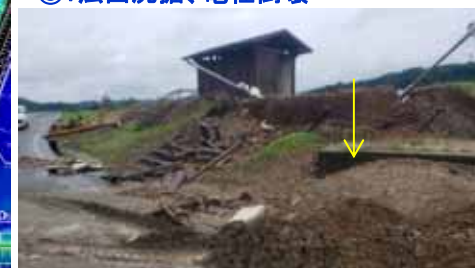
⑧: 法面洗掘、電柱倒壊
