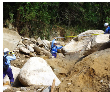
土砂災害被害状況の調査
