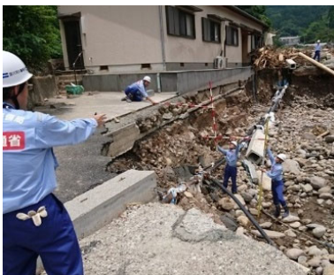
河川被害状況の調査
