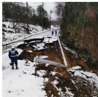
道路被害状況の調査
