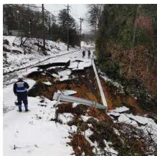
道路被害状況の調査
