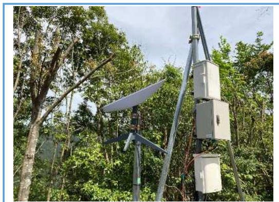
【スターリンク(衛生通信機器)】
