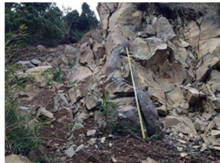
拡大2 不安定な岩塊の状況
