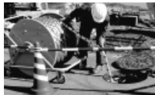
国土交通大臣賞 下水道圧送管路における硫酸腐食箇所効率調査技術 (株)クボタ
