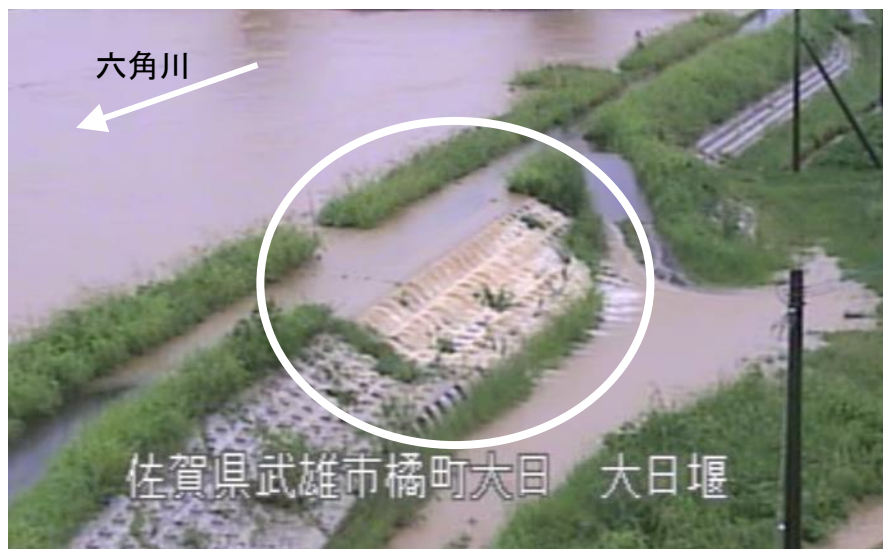
③ 8/14 7:15 六角川29k000付近 武雄市橘町大日付近(越水状況)
