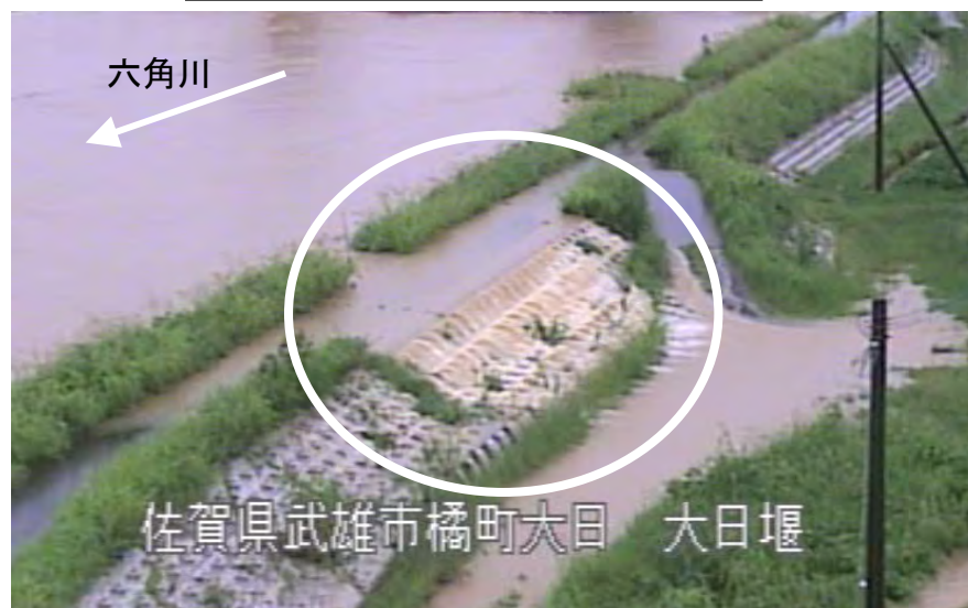
③ 8/14 7:15 六角川29k000付近 武雄市橘町大日付近(越水状況)
