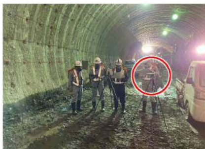
【会議用スピーカーの設置（現場側）】
