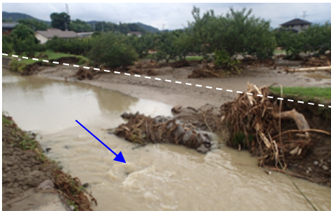
護岸の被災状況
