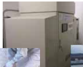
電源喪失対策 (予備電源の整備)
