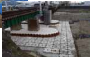
鉄道橋梁の流失・傾斜対策
