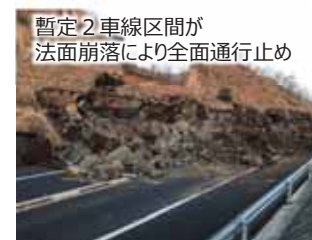
常磐自動車道の被災状況
