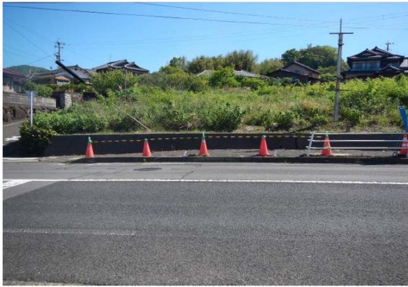
写真-2 業務改善前の損傷写真
