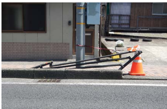
写真1 道路附属物損傷の例
