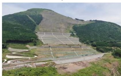
図-4 被災状況及び復旧状況(斜面崩壊部)
