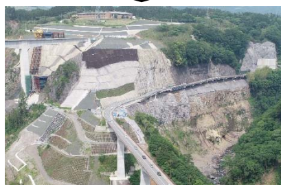
図-3 被災状況及び復旧状況(栃の木地区)
