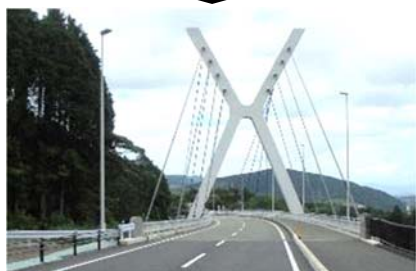
図-2 被災状況及び復旧状況(桑鶴大橋)
