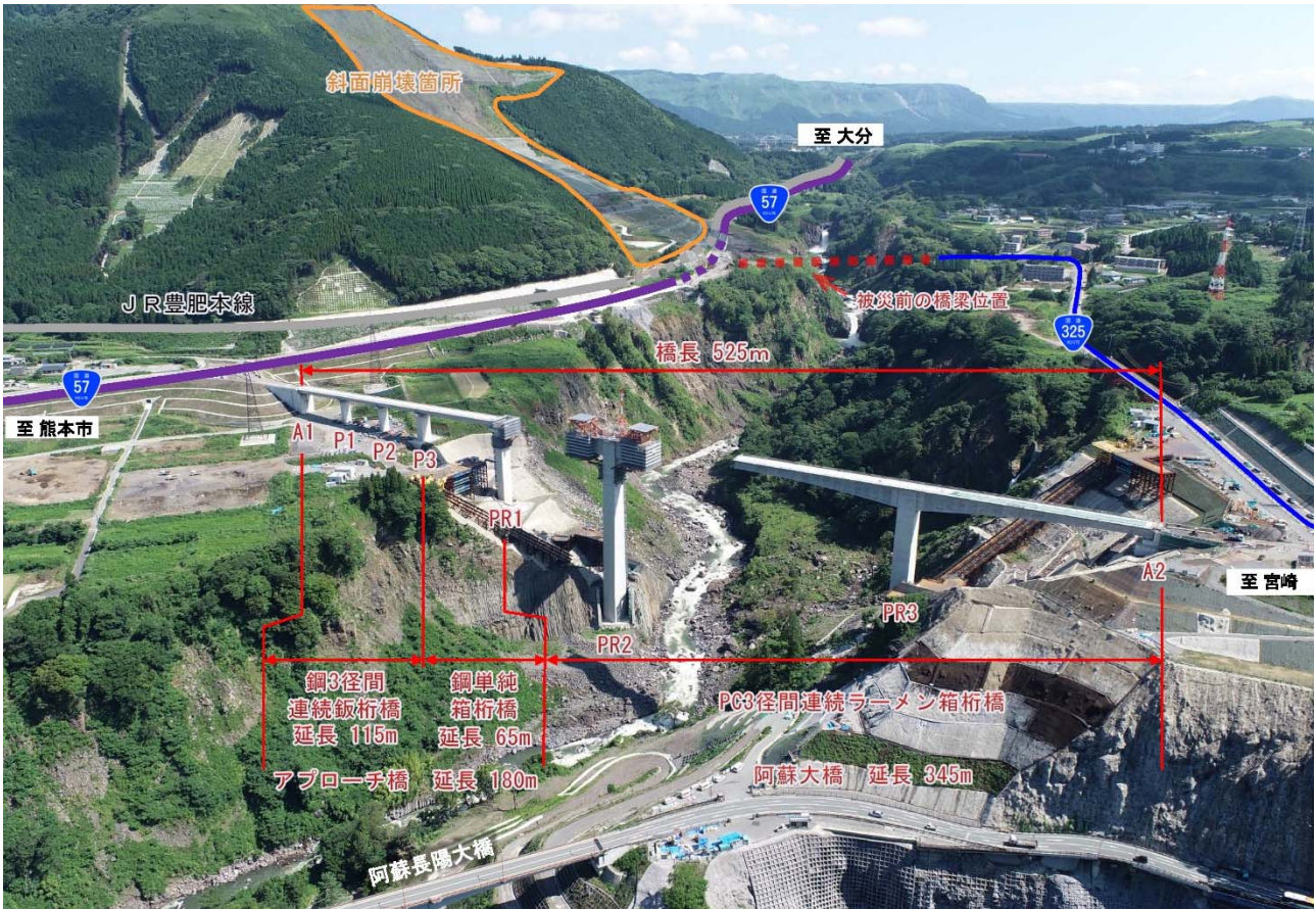
図-15 2020年6月下旬時点の復旧状況
