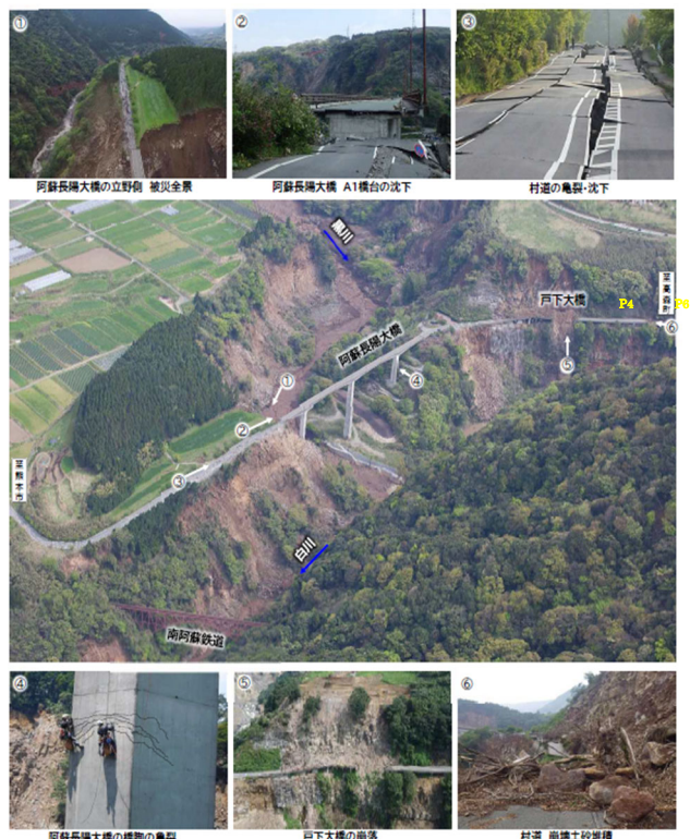
写真-1 長陽大橋ルートの被災状況写真
