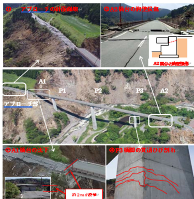
写真-4 阿蘇長陽大橋の損傷状況写真
