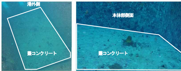
図-17 ケーソンNo.5蓋コンクリートの全体写真と近接写真
