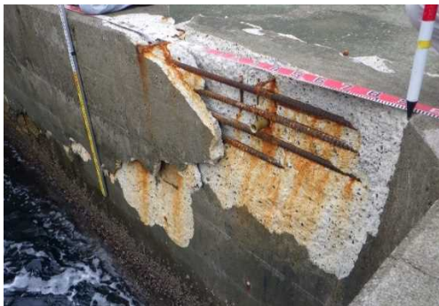
図-4 ケーソンNo.5の鉄筋露出写真
