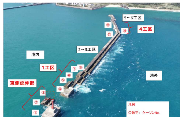
図-2 名瀬港防波堤（沖）の2018年被災状況写真
