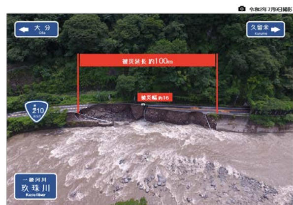
写真-3 7月9日時点の道路崩壊（赤岩地区）
