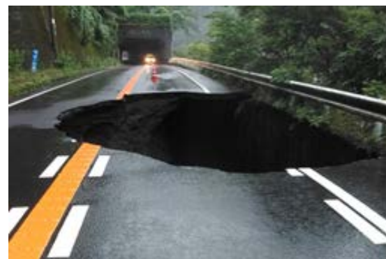
写真-2 7月7日時点の道路陥没（赤岩地区）
