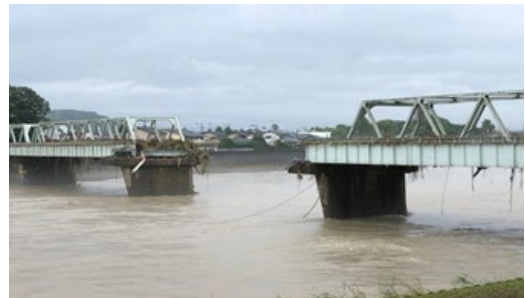
図-1 西瀬橋一部流失の状況
