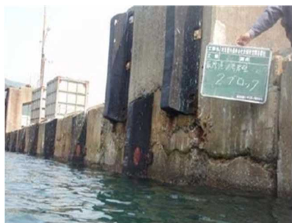
図-4 老朽化によるひび割れ，破損が生じた岸壁
