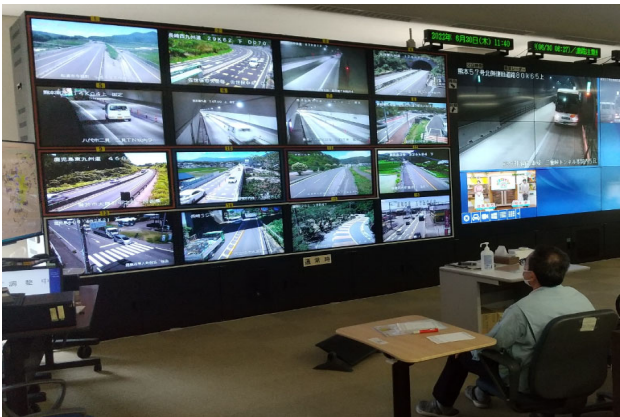
図-13 みちセンターでのモニタ監視状況（現状）
