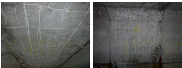
写真-2 変状写真 (左: 頂版, 右: 側壁)
