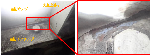
写真-5 主桁亀裂：支承中心より胸壁側
