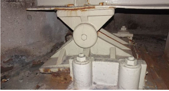
写真-2 支承損傷状況
