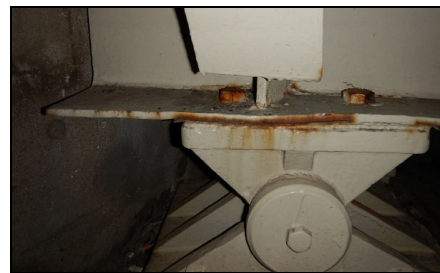
写真-10 ソールプレート未設置状況
