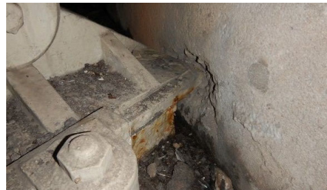
写真-3 接触・欠損状況
