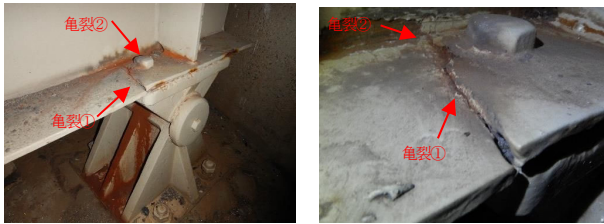
写真-7 亀裂①、②の状況
