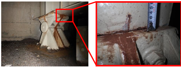
写真-6 主桁亀裂：下フランジ下面
