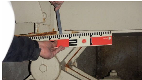
写真-4 下フランジの変形
