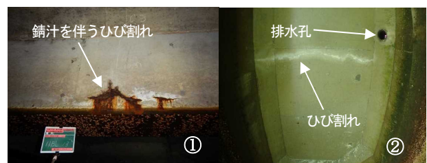
図-7 目視調査（①上部工(梁)劣化、②上部工(床版)劣化）
