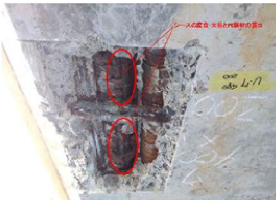
シース管内部のPC鋼材の露出状況
