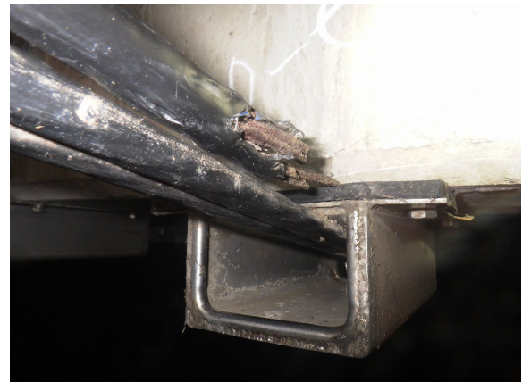
写真-2 外ケーブル損傷状況
