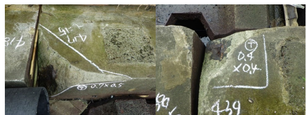
写真-3 護岸本体部の断面欠損
