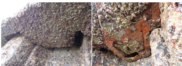
写真5 笠コンクリート下面の抜け落ち
