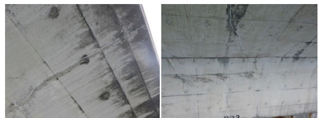
写真-1 護岸本体部のひび割れ
