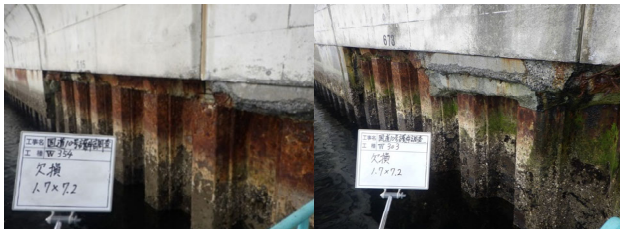
写真4 笠コンクリート剥離
