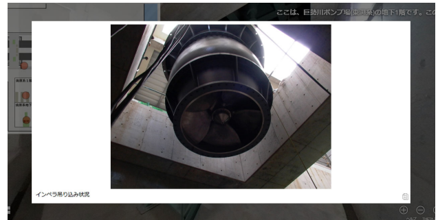
図-5 ポンプ真下からの映像（建設当時）
