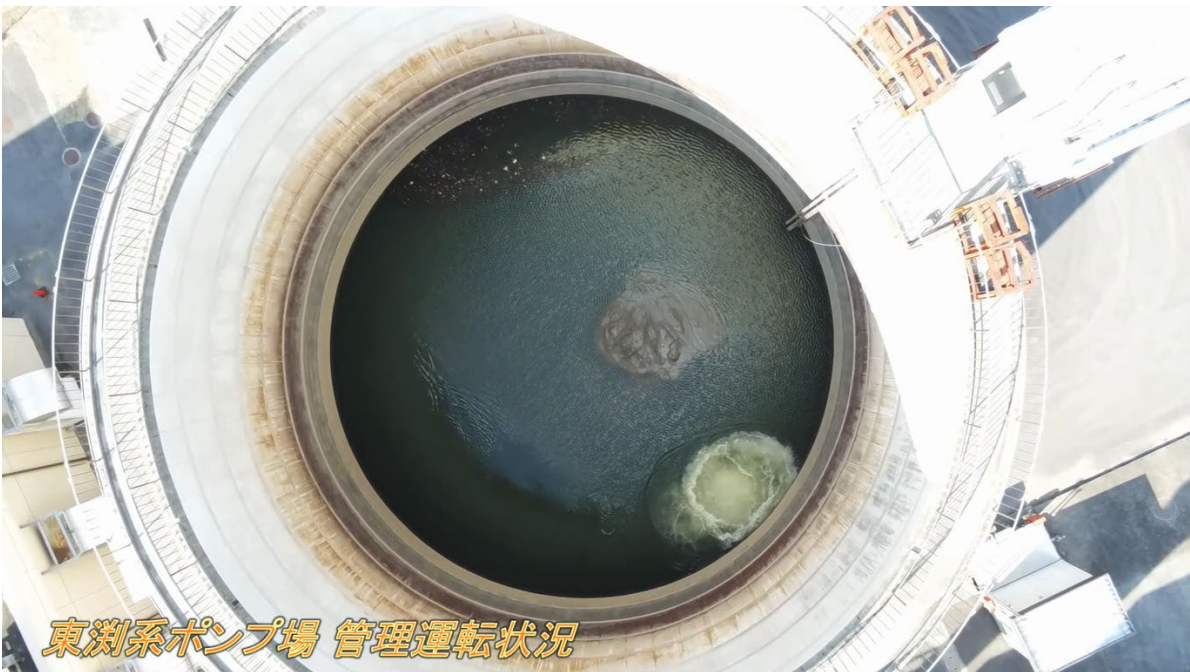
図8 吐出水槽（ポンプ稼働中）の空撮映像
