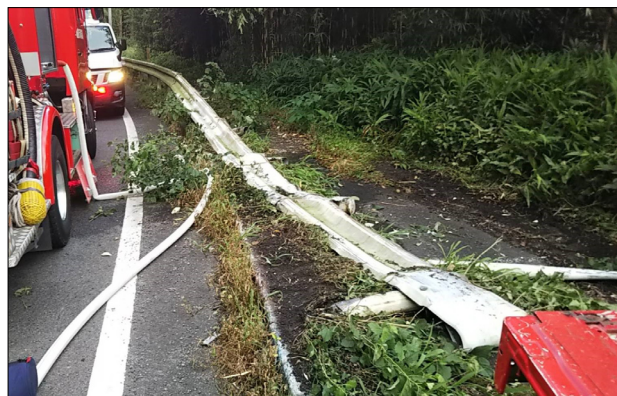
(写真2 道路附属物損傷)
