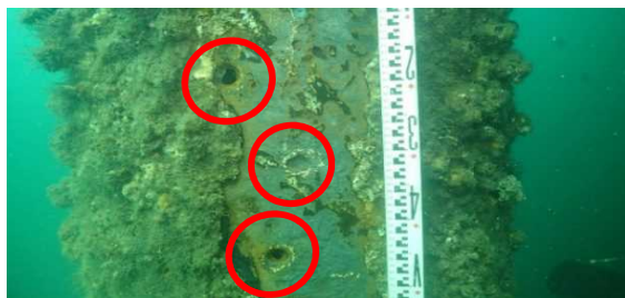
図-11 鋼管の腐食及び孔食状況
