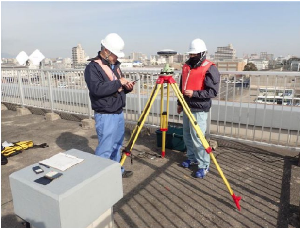
写真-2 Berth Surveyor (基準局) 設置イメージ
