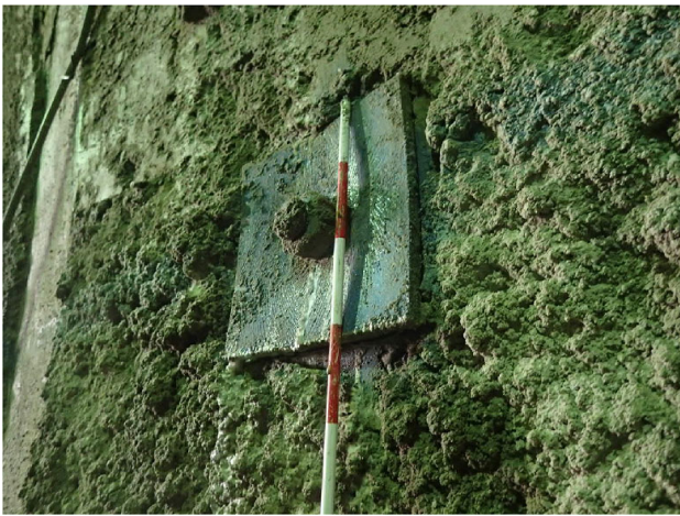
図-7 ロックボルト座金変形状況
