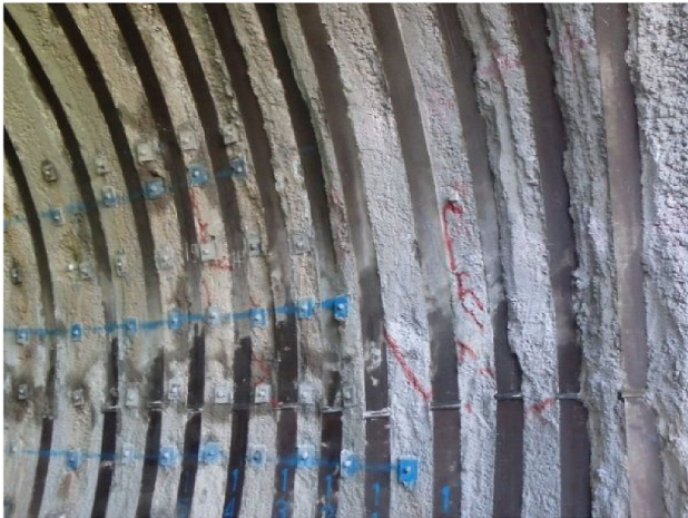
図-6 坑口右側 吹付クラック発生状況
