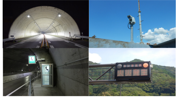
写真-4 主な道路電気通信設備
