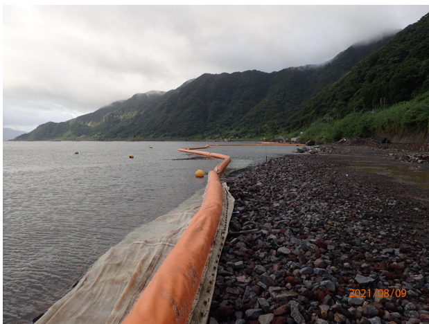
写真-4 台風後の汚濁防止フェンス状況
