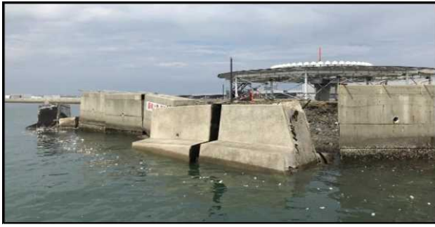
写真4 関西国際空港のVOR/DME部の護岸転倒箇所 (出所:台風21号越波等検証委員会資料)
