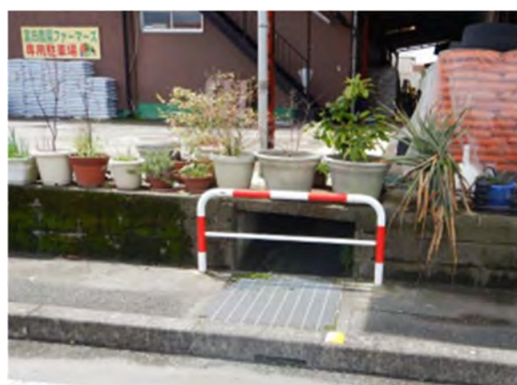
図-11 まち歩き中の危険箇所② 対策後
