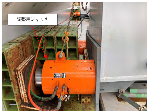
写真-14 支点部調整用ジャッキ
