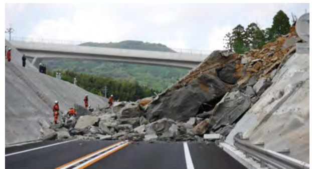
写真-1 切土のり面の崩壊状況
