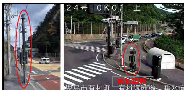
写真2 新たに増設したCCTVとそれをういた遮断装置周辺の監視の様子（桜島口交差点・垂水向き）
