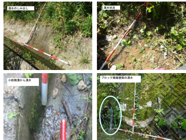
写真1 AL-2-0040の湧水状況
