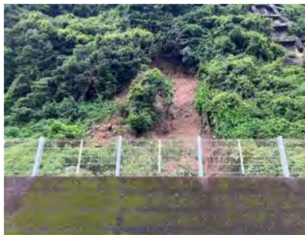
写真-2 南串山赤間第1ロックシェッド付近の表層崩壊
