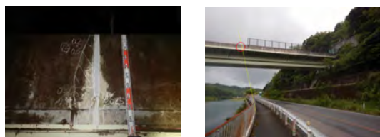
写真-1 特徴的な鋼床版箱桁壁高欄のうき
