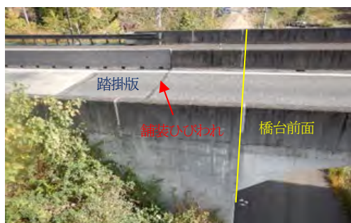
写真-2 橋台背面の舗装ひびわれ（ポータルラーメン）
