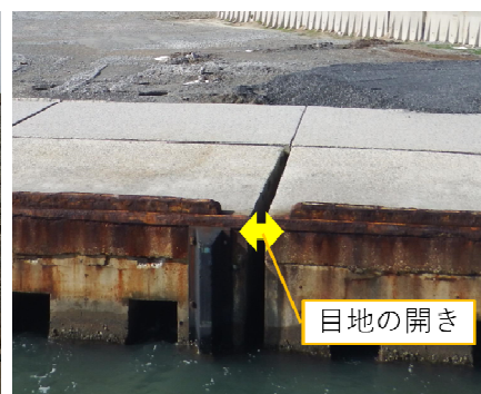
写真-4 ケーソン間の目地開き
