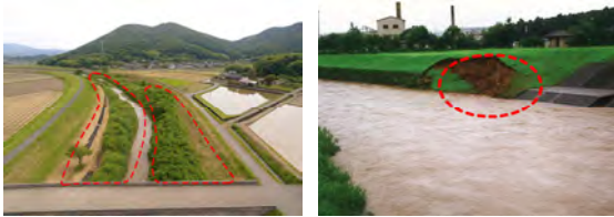
図-10 流下阻害（左）と堤防の崩れ（右）の指摘
