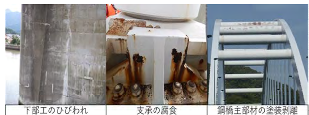
写真-2 伊万里湾大橋老朽化状況
