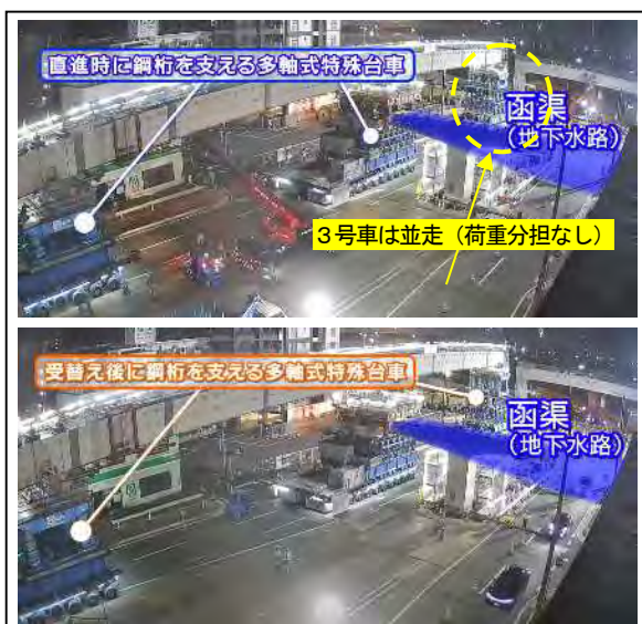
図-14 3号車の並走状況
