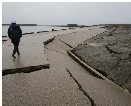
写真-3 ケーソン背後の地盤沈下
