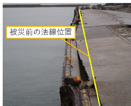
写真-2 岸壁法線の変位
