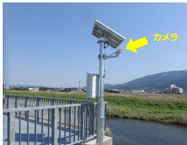
写真-1 簡易型の河川監視カメラ
